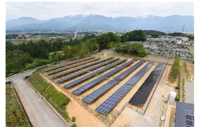
リユース品を使用した発電所の例
